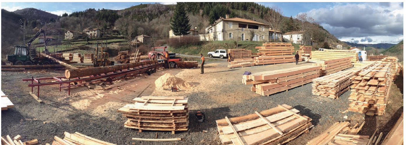
Das Material für den nächsten Dachstuhl. Mit dem neuen Holzverarbeitungsbetrieb wollen wir auch für den Innenausbau produzieren.
