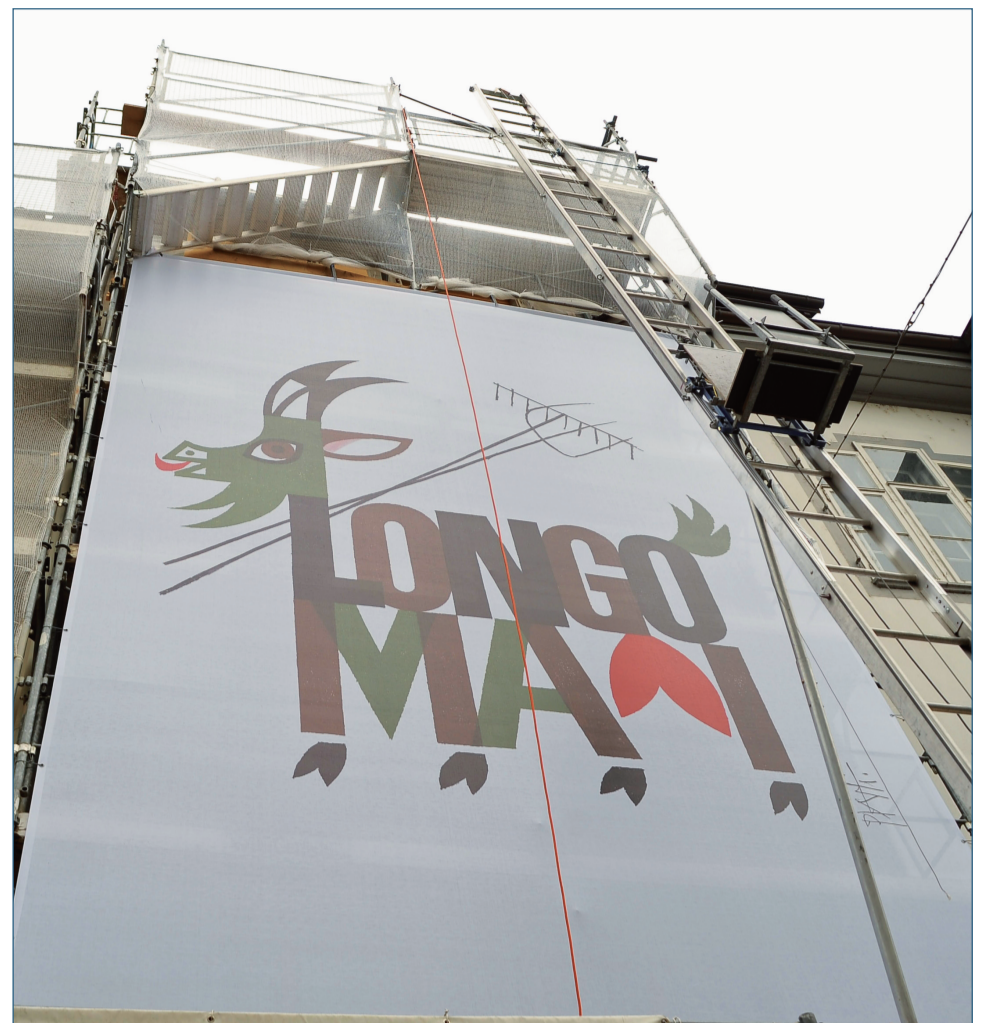
Bei Umbauarbeiten am Longo mäi Haus in Basel kleidet die vergrößerte Piatti-Lithographie das Gerüst ein. Foto: Martin Töngi, Basel
